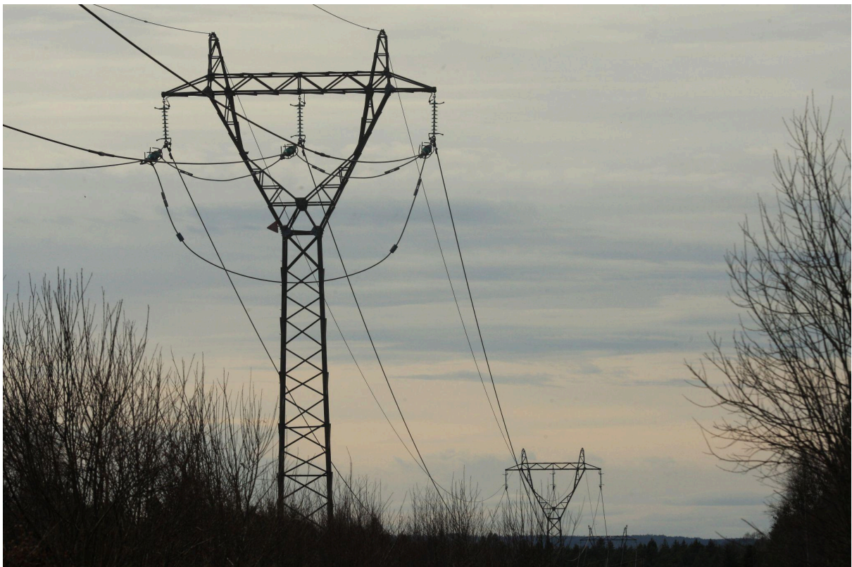
Kraftledning Foto: Mostphotos
